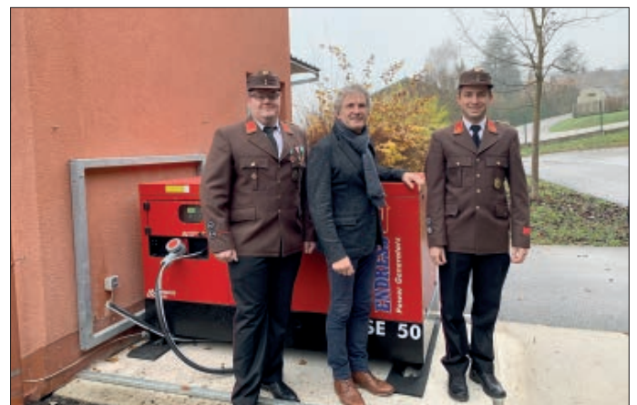
Notstromversorgung des Gemeindezentrums
